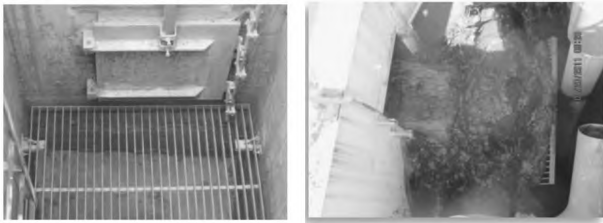
图 12 浮渣排放门/格栅及排渣实况
